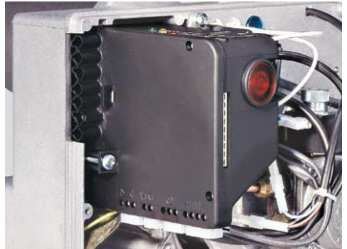
安装有点火变压器的控制盒
